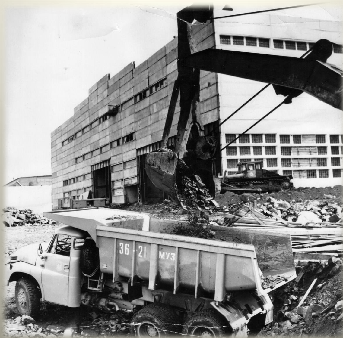
СМУ «Рудстрой» треста «Апатитстрой». Сооружается новая автобаза для рудника Центральный на Плато Расвумчорр. 1976 г. ГОКУ ГАМО в г. Кировске. Ф. Р-520. Оп. 1. Д. 2460.
